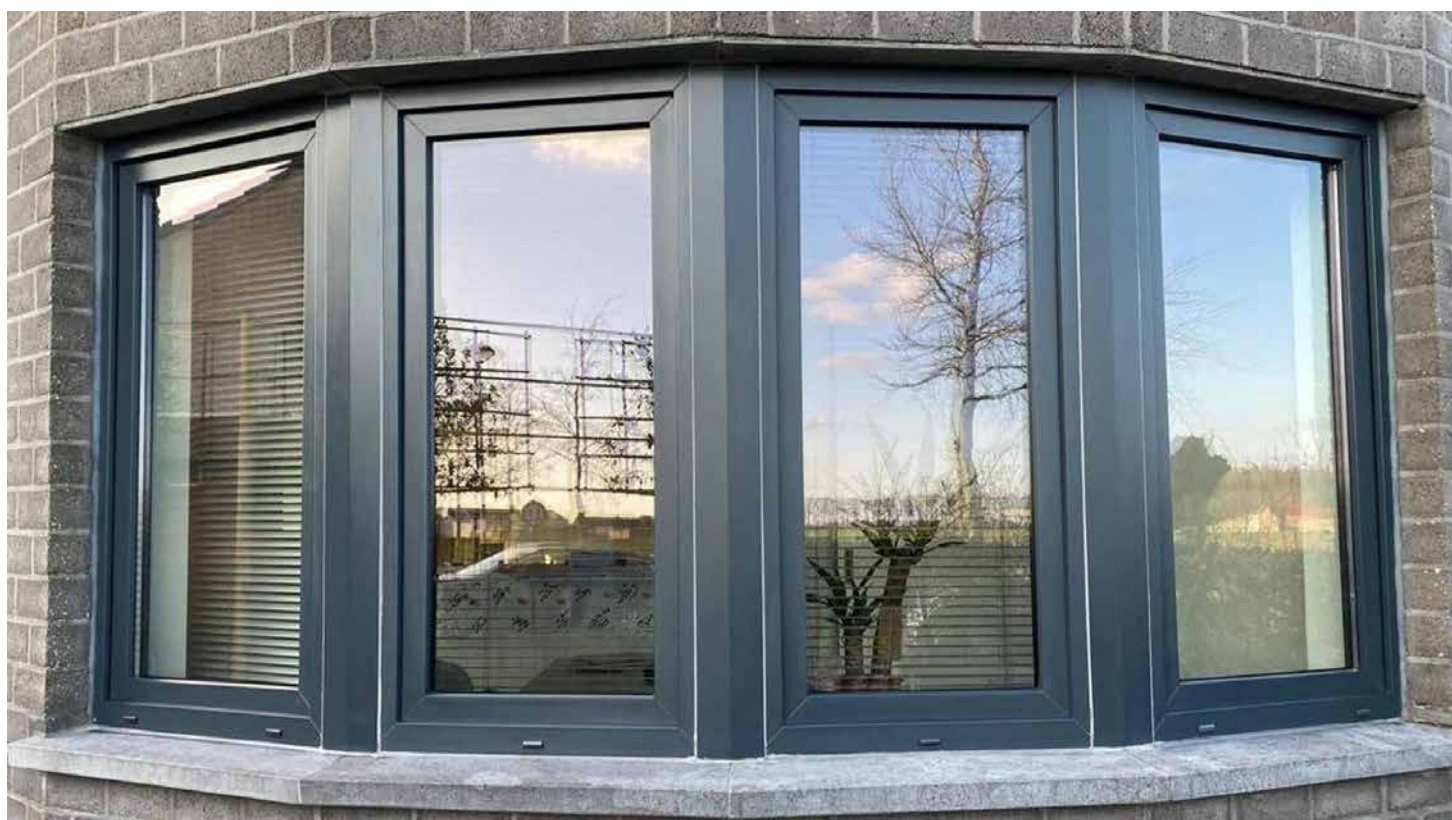
Degradatie van tien jaar oud geanodiseerd aluminium door een volledig gebrek aan onderhoud
