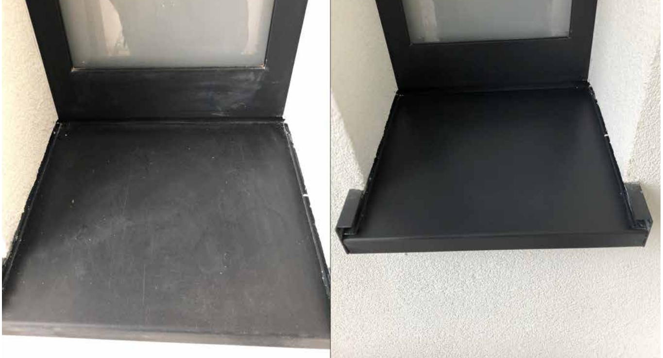
In beeld: Aluminium profielen met cement- en kalkvervuiling voor en na reiniging
